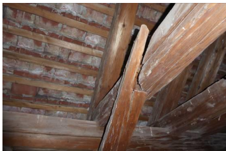
Obr. 8: Statická porucha – zlomenie dreveného kolíka a vysunutie vzpery.
