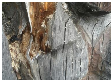
Obr. 11: Poškodenie sochy Široký
