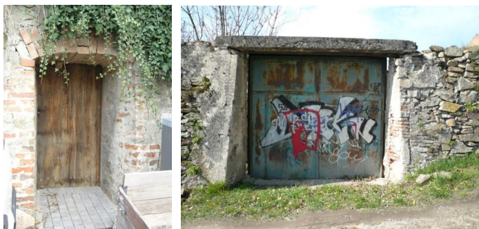
Obr. 13: Perforácia opevnenia novodobými otvormi do okolitých viníc (zdroj C) s vyhovujúcou výplňou, s nevyhovujúcou výplňou.
